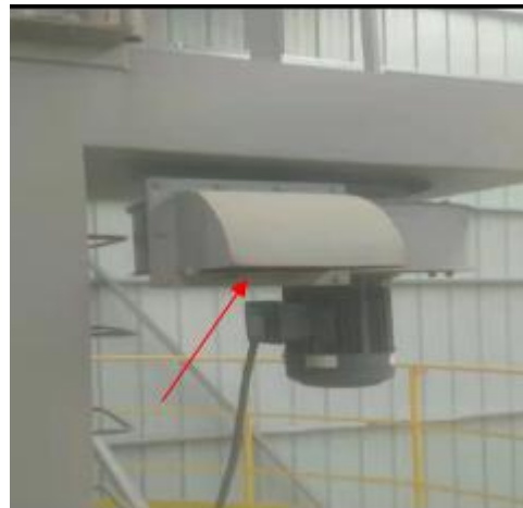
（除尘器大呼吸排气口）
