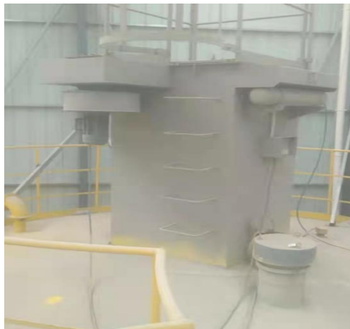
（水泥筒仓顶部脉冲布袋除尘器）
