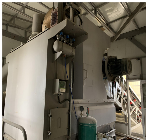
（搅拌机顶部脉冲布袋除尘器）
